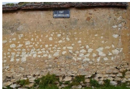
Mur en maçonnerie de moellons de calcaire et de meulière. L'enduit à la chaux s'est progressivement dégradé par les remontées capillaires du sol.
