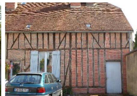
Commun d'hôtel particulier en pan de bois et remplissage en brique – 8, rue de la place de l'Hotel de Ville
