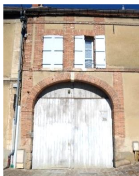
Facade en enduit avec nervures de brique du XVIII e siècle 4, rue Pierre Frite
