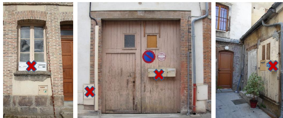
Photos 1, 2 et 3 : Boîte aux lettres non encastrées ou en débord sur le domaine public, interdites. Les coffrets techniques ne doivent pas interrompre des encadrements de brique. (Photo 2)
