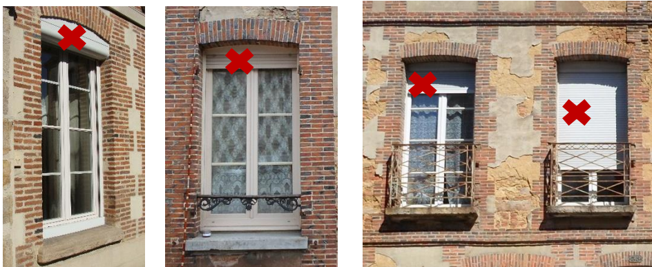
Exemples de volets roulants en PVC interdits avec coffre saillant ou intégré
