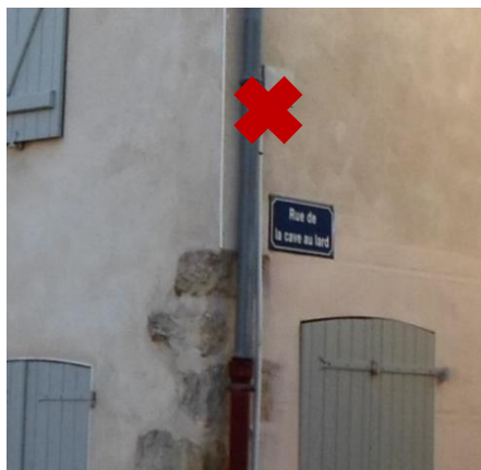
Enduit avec baguette d'angle en PVC interdite
