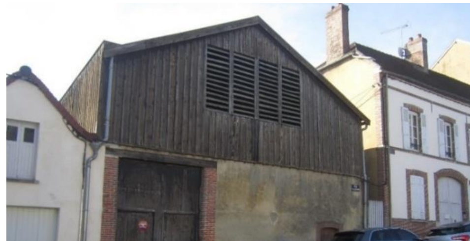
Bardage en bois de planche verticale recouverte d'un couvre joint – Hangar de séchage
