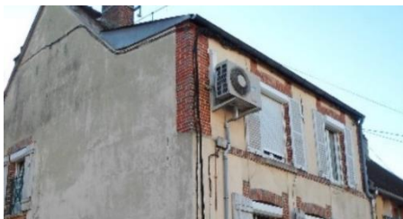
Photo 7 : Les aérothermes ou climatiseurs sont interdits sur les bâtiments remarquables et sur les façades, vues du domaine public, des autres bâtiments.
