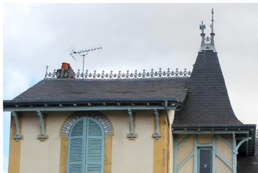
Couverture en ardoise avec des crêtes et des épis de faîtage en zinc
