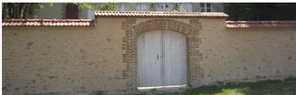
Photo 6 : Un couronnement de mur de clôture en de tuiles mécaniques à côte, dont le faîtage est recouvert d'une tuile canal à bourrelet de recouvrement ou d'un solin en mortier de chaux
