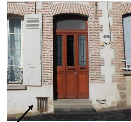
Photo 11 : Grille de protection d'un coffret
