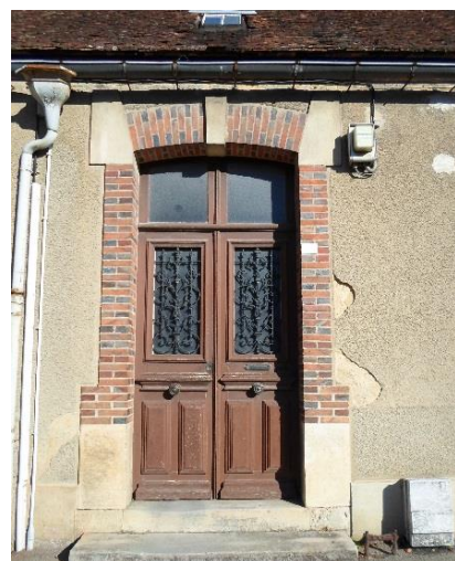
Enduit balayé, en retrait et souligné par un joint lissé
